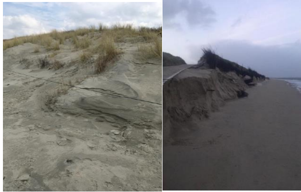
Düne unterhalb sowie in der Nähe des Restaurants (hier sind die Spuren des Abtragungsprozesses von der Sturmflut im Winter 2016/17 zu sehen)
